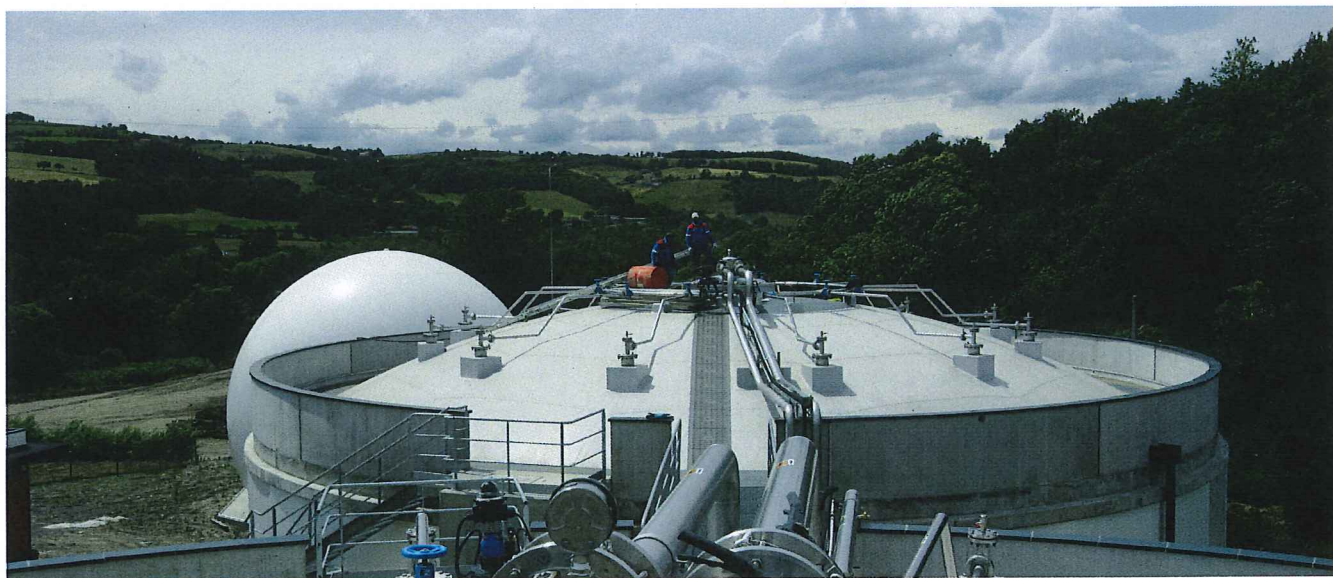
Méthanisateurs de la station d'épuration Furania
