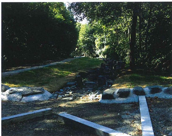
Restauration écologique des berges et du lit de la rivière Bozançon (Rive-de-Gier)
