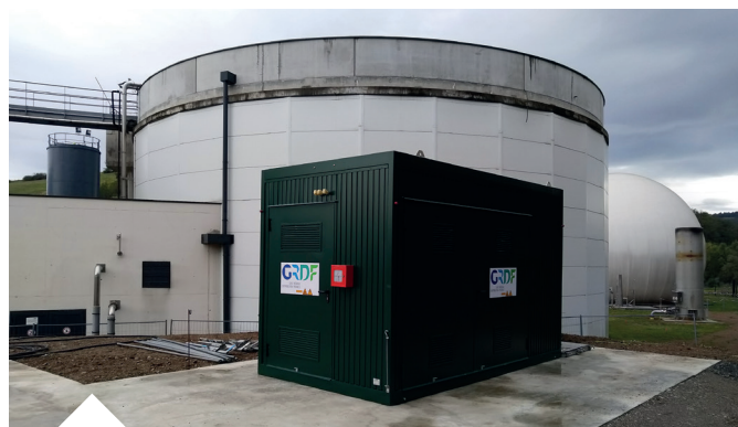
Poste d'injection GRDF à Furania
